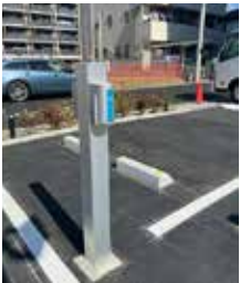
EV充電設備
